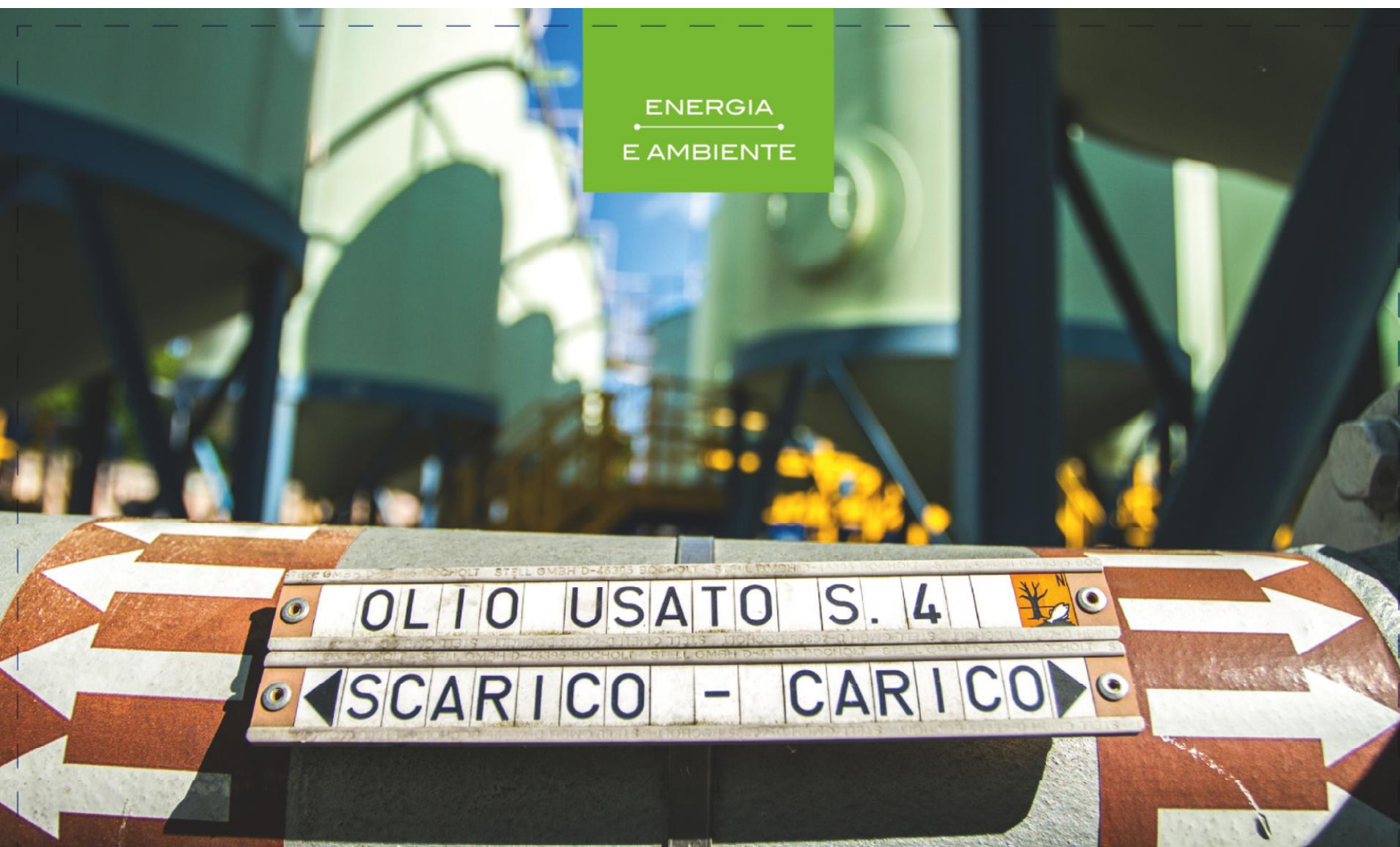
PARTICOLARE DI UN DEPOSITO OLIO LUBRIFICANTE USATO GESTITO DAL CONOU
